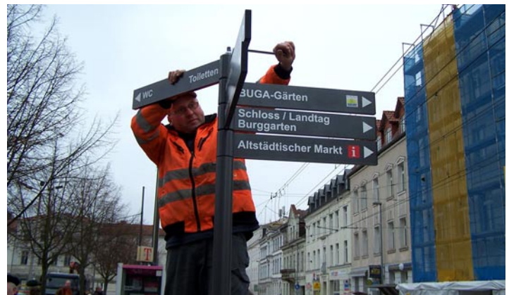
Mitarbeiter der SDS Thomas Warncke montiert die Hinweisschilder an der neuen Standsäule auf dem Grunthalplatz
